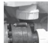
Vanne Guillotine et Raccord de Pompe
