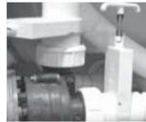
Raccord de la pompe et vanne guillotine
